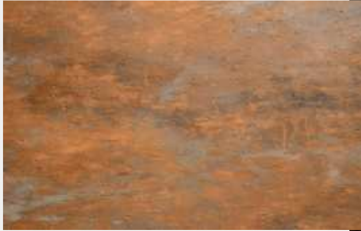
25 . 铁锈c Rust C
