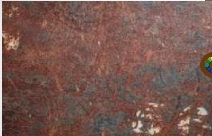
26 . 铁锈d Rust D
